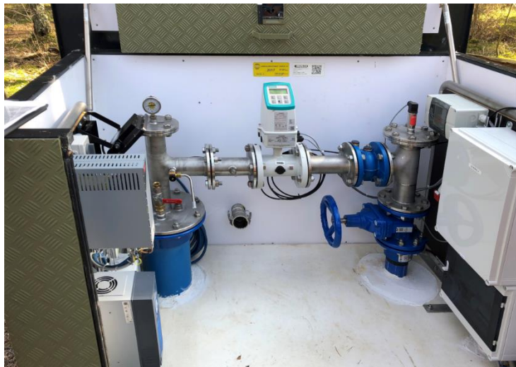
Installationerne i et typisk pumpehus
