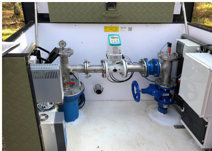
Installationerne i et typisk pumpehus
